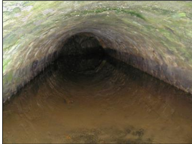
Et le début maçonné de la galerie noyée et effondrée
