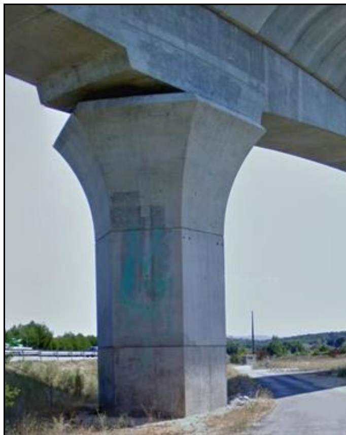
Et, plus massive, l'une des piles de rotation de la travée centrale
