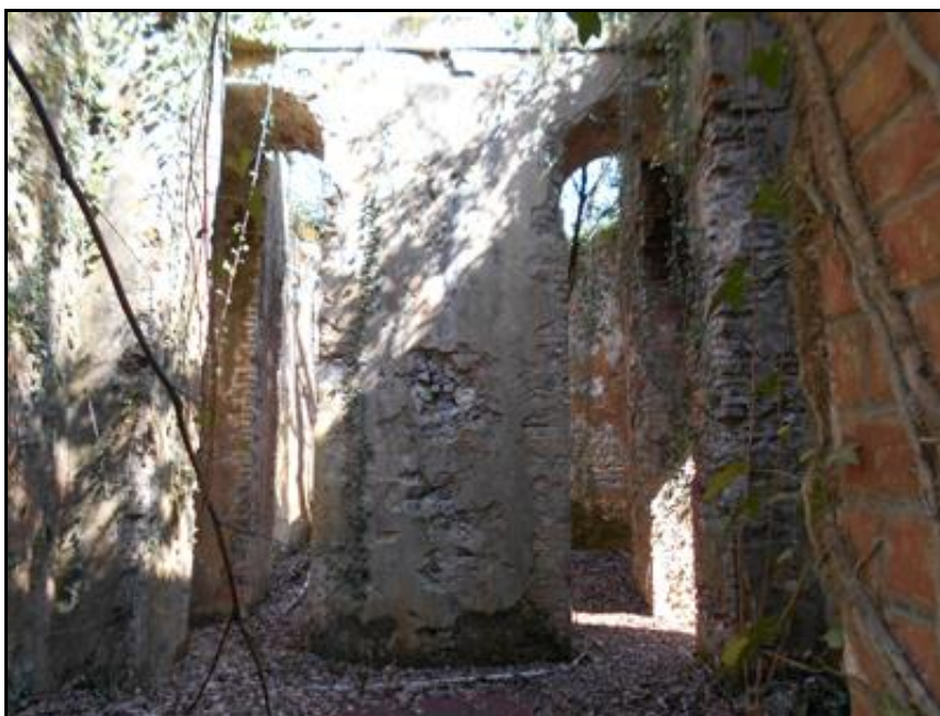
L'intérieur du local technique avec un puissant mur central destiné à supporter le poids de la cuve métallique
