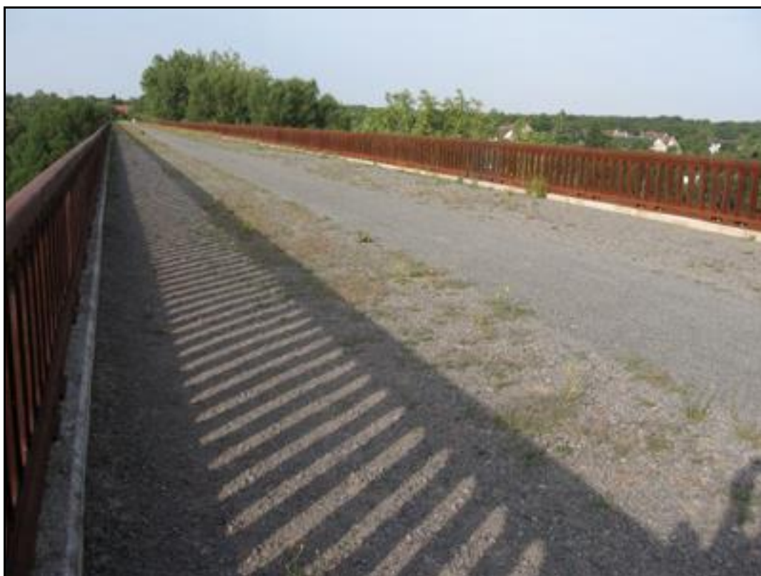
Le tablier du viaduc vu dans le sens de la ligne Les deux voies de la ligne vers Issoudun passaient à gauche, et celle de la ligne vers Marçay, à droite
