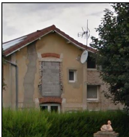
Et des raccords de crépi pour le moins douteux
