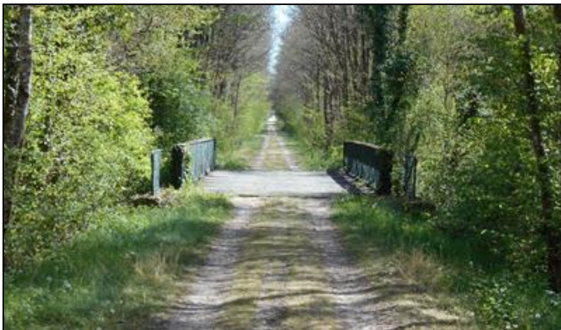
Et ici et ci-après, le pont sud sur la Petite Sauldre vu dans le sens de la ligne
