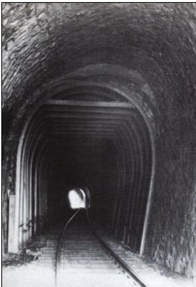
La galerie complètement déformée du tunnel
