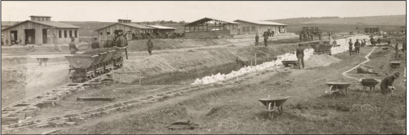
13 mai 1918. De la gauche vers la droite, la remise à locomotive, l'atelier d'usinage suivi de la forge, l'abri ouvert de stockage des produits pétroliers et le magasin régimentaire. Les quais sont en travaux.
