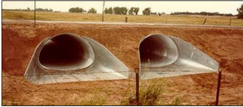
Ponceaux tuyaux en tôle ondulée (TTO) modernes de section caquoïdale
